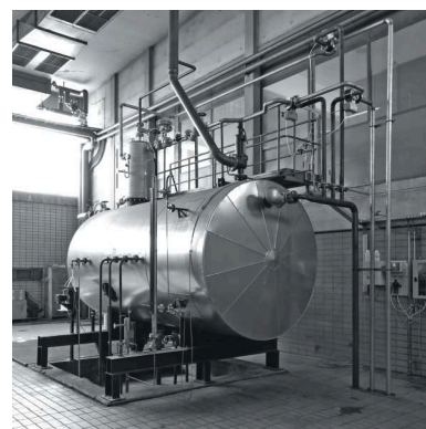
Speisewasserbehälter Feed water tank
